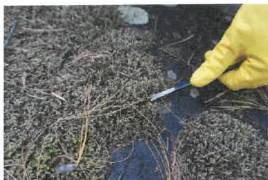
Foto particolare durante la rimozione meccanica dei muschi prima del trattamento
