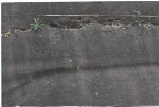
Foto particolare delle striature scure causate dal percolamento di acqua
