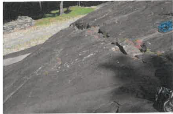
Foto particolare della lesione principale con andamento SE-NW
